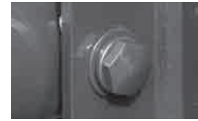
図-13 歩行者の安全性に配慮した丸頭の六角ボルト
