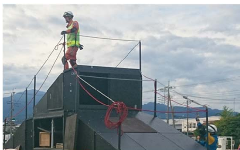
転落防止のための手すりロープ
