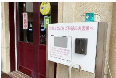
各所に設置されているインターホン
